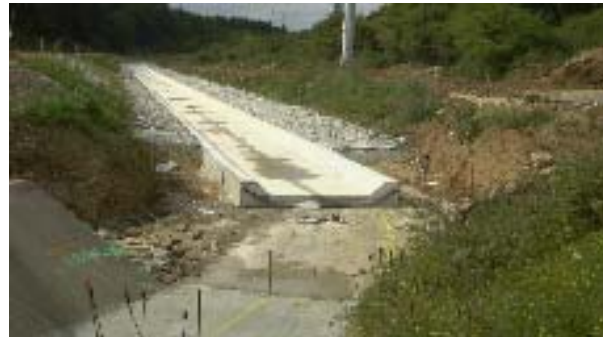
Im ersten 1400 m langen Bauabschnitt wurde der neue trogförmige Kanal in den natürlichen Bachlauf verlegt
